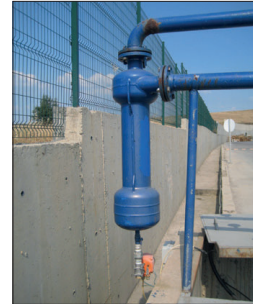
Resim 1. Ham Su Deposu Girişinde Sudan Kumları Ayıran Siklon Katı Ayırıcı
