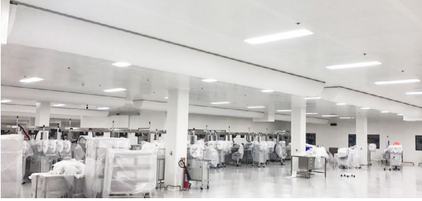
Resim 2. Türkiye'de bulunan Temiz oda ISO Class 3 standartlarının izlendiği farmasötik tesiste tekstil kanal uygulaması
