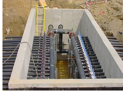
Şekil.6-Yerinde inşa edilen saha kolektörü
